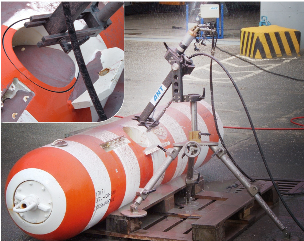
Abbildung 25: Einsatz der Wasserstrahlschneidtechnik ( oben links - Detailansicht) (mit freundlicher Genehmigung der ANT Applied New Technologies AG, Lübeck).
